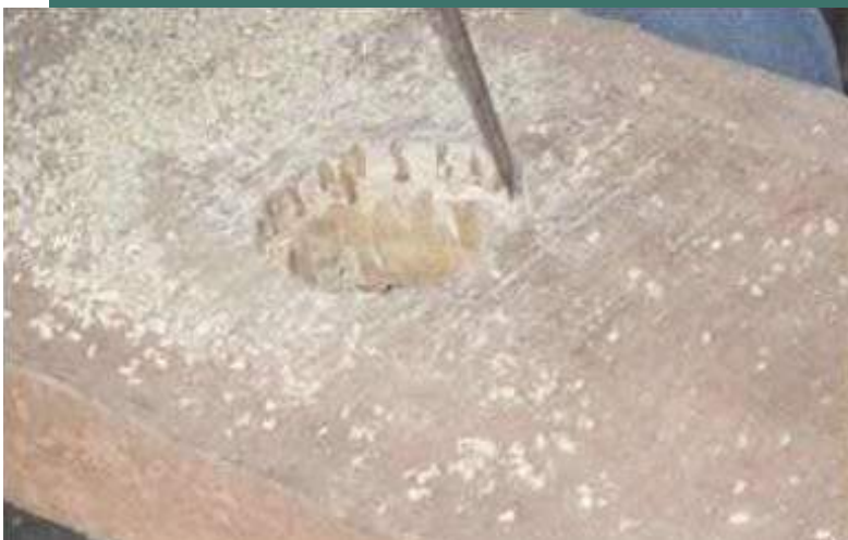
Figura 15 - Cortes na madeira
