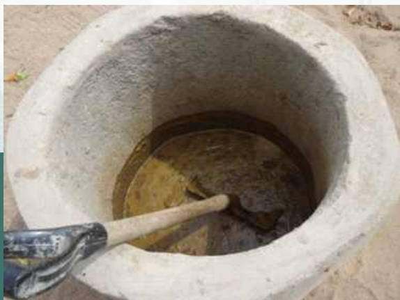
Figura 29 - Caixa de entrada abastecida
