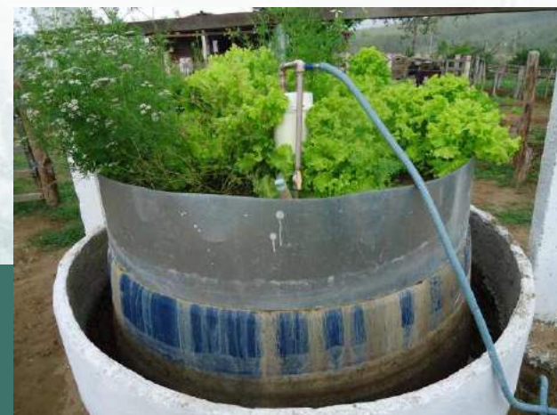
Figura 28 - Saída da câmara de biodigestão
