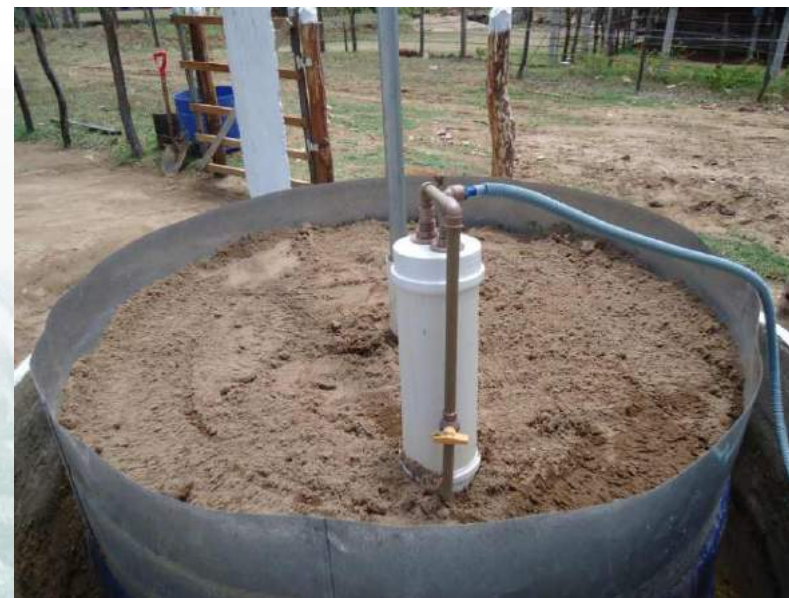
Figura 19 - Filtro de cano de PVC instalado
