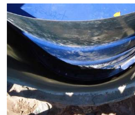
Figura 23 - Cúpula encaixada na câmara biodigestora
