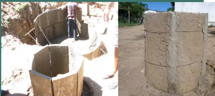
Figura 8 - Fotos da caixa de entrada da matéria-prima para o biodigestor
