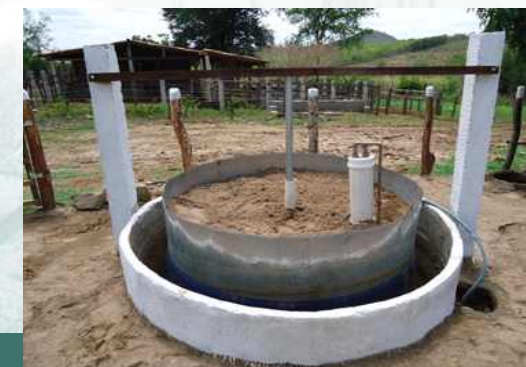
Figura 24 - Filtro de cano de PVC instalado
